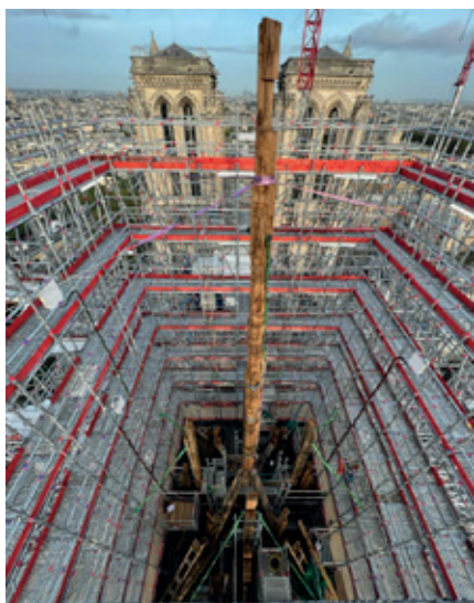
Début du montage de la charpente de la flèche de Notre-Dame de Paris.
